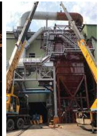
集塵設備改善
